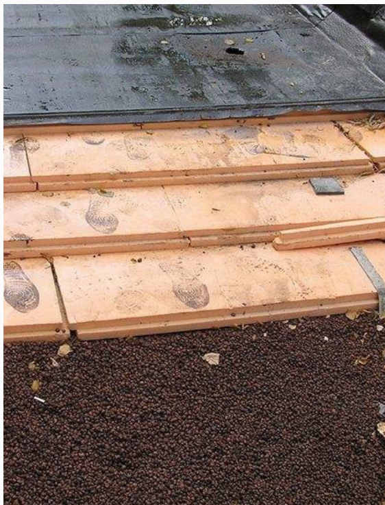
Мосты холода и воздушные карманы видны не вооружённым взглядом
